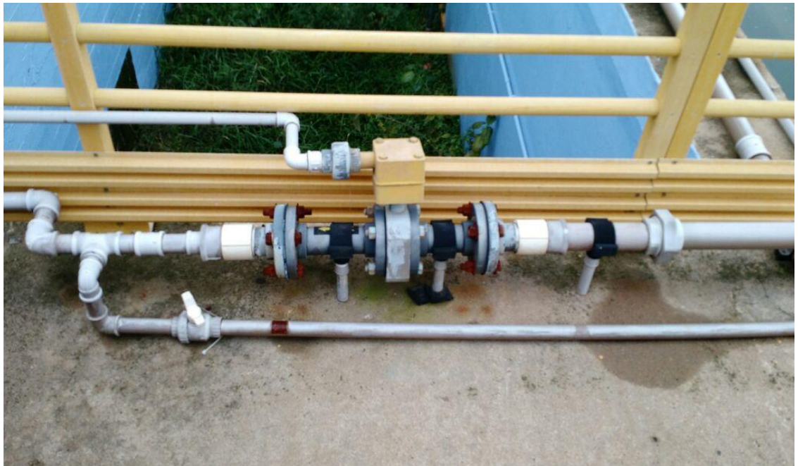
Imagem 6: Bomba que injeta cloro na água.
