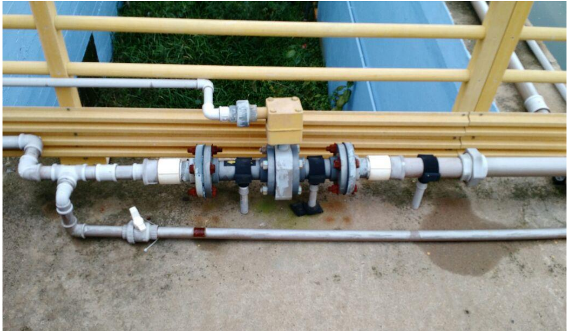
Imagem 6: Bomba que injeta cloro na água.
