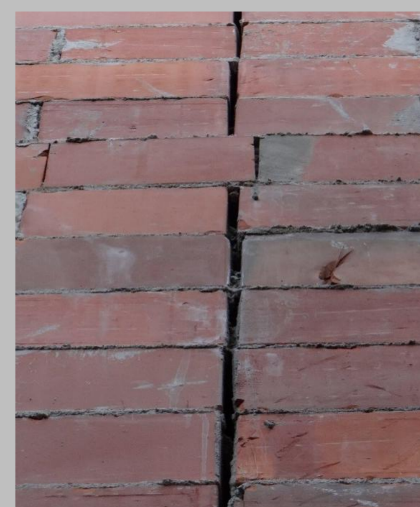
Junta de dilatação interrompida
