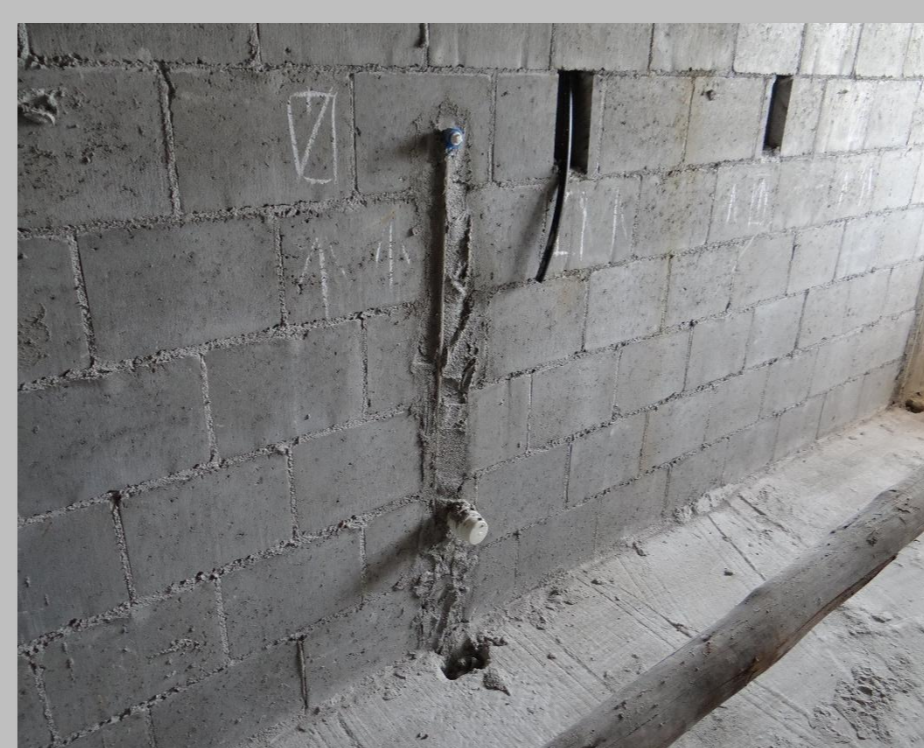
Rasgos indevidos para a passagem das instalações hidráulicas.
