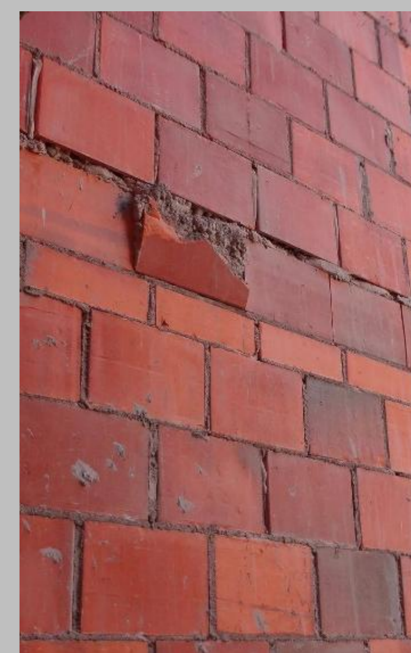
Blocos danificados e com colorações não homogêneas.
