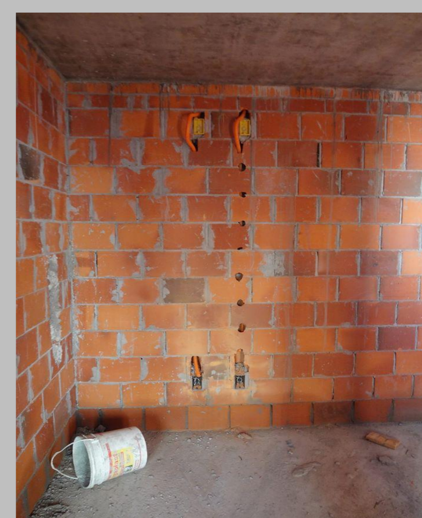
Rasgos indevidos para instalações elétricas.
