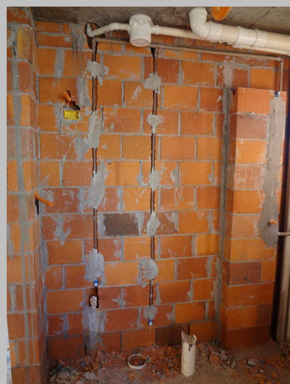
Rasgos indevidos para a passagem das instalações hidráulicas.
