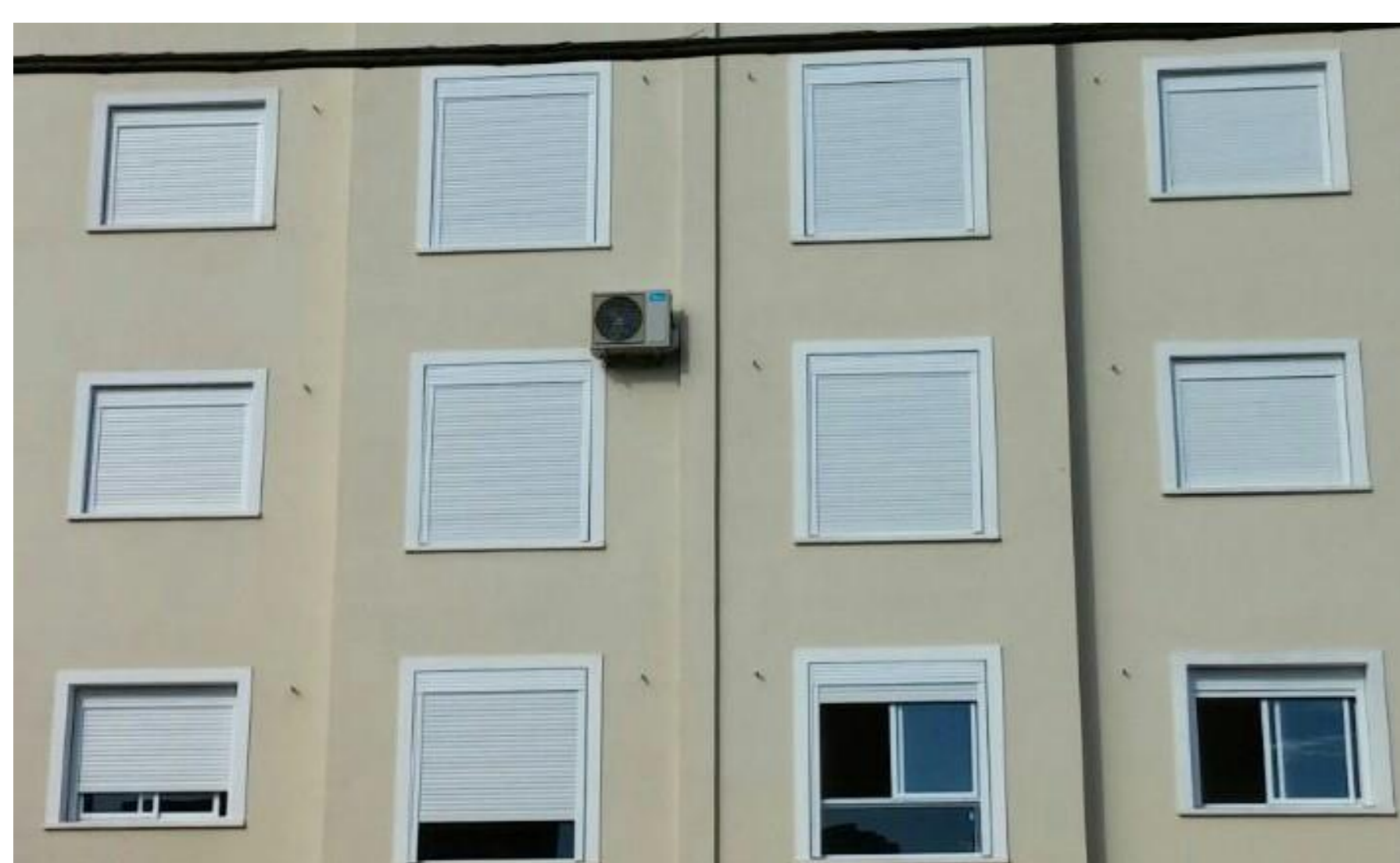
Figura 1 – Sistema de climatização alinhado com esperas para tubulação água
